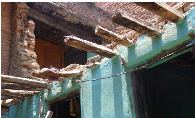
Das Haus des Gesundheitspädagogen der Station, das durch das zweite schwere Erdbeben weitgehend zerstört wurde.
